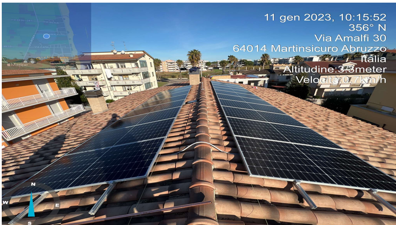
Martinsicuro impianto su edificio residenziale kWp 8,0
