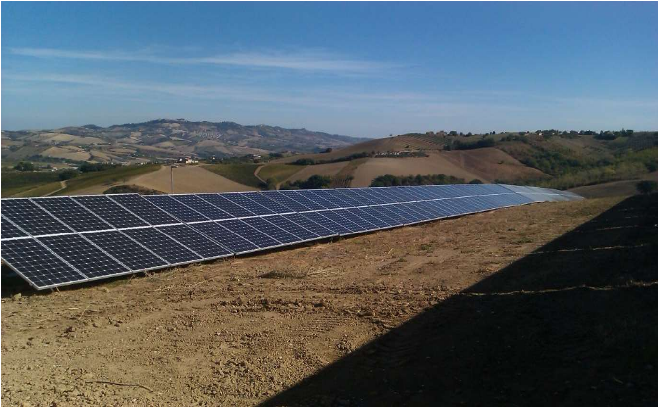
Offida (AP) - Impianto a terra 0,998 MW
