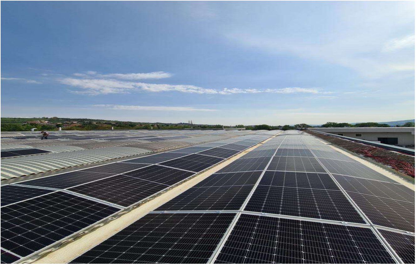
Ascoli Piceno impianto su opificio industriale kWp 990
