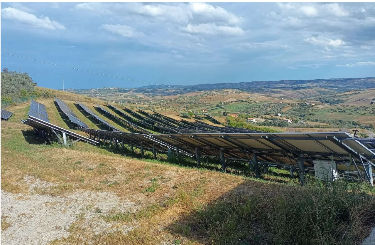
Appignano 2 (AP) – Impianto a terra da 0,440 MW
