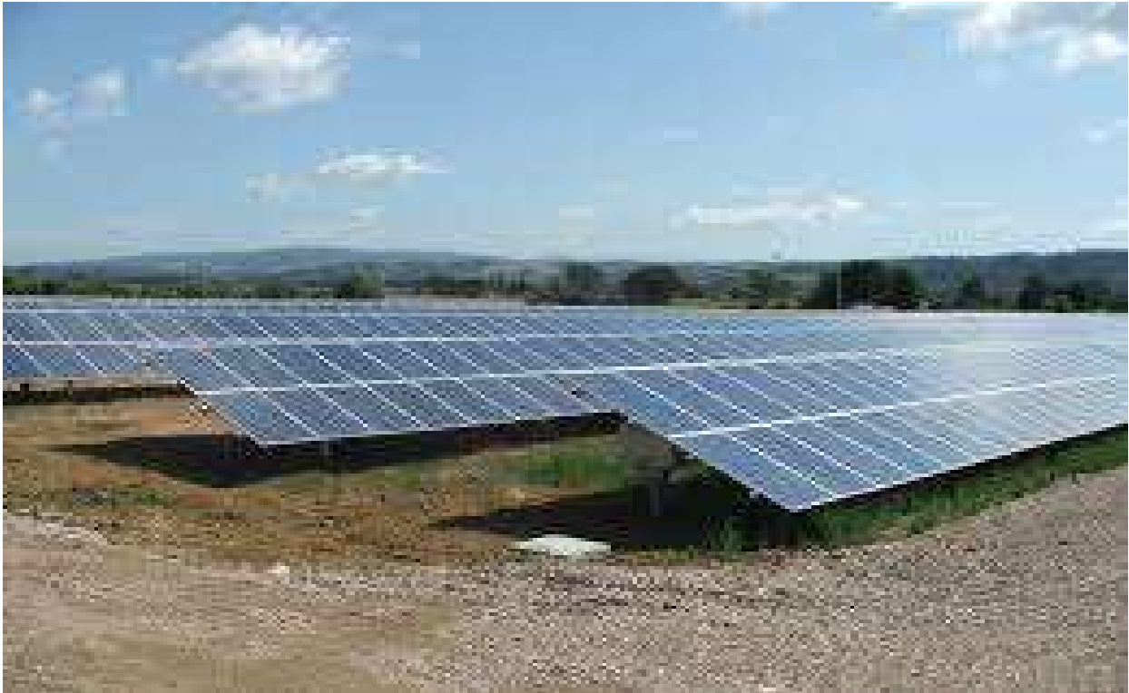
Appignano 1 (AP) - Impianto a terra da 0,700 MW
