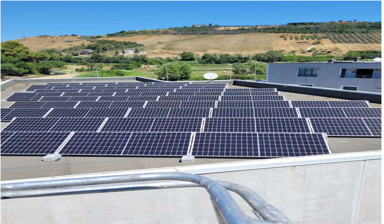
Ascoli Piceno impianto su opificio industriale kWp 20
