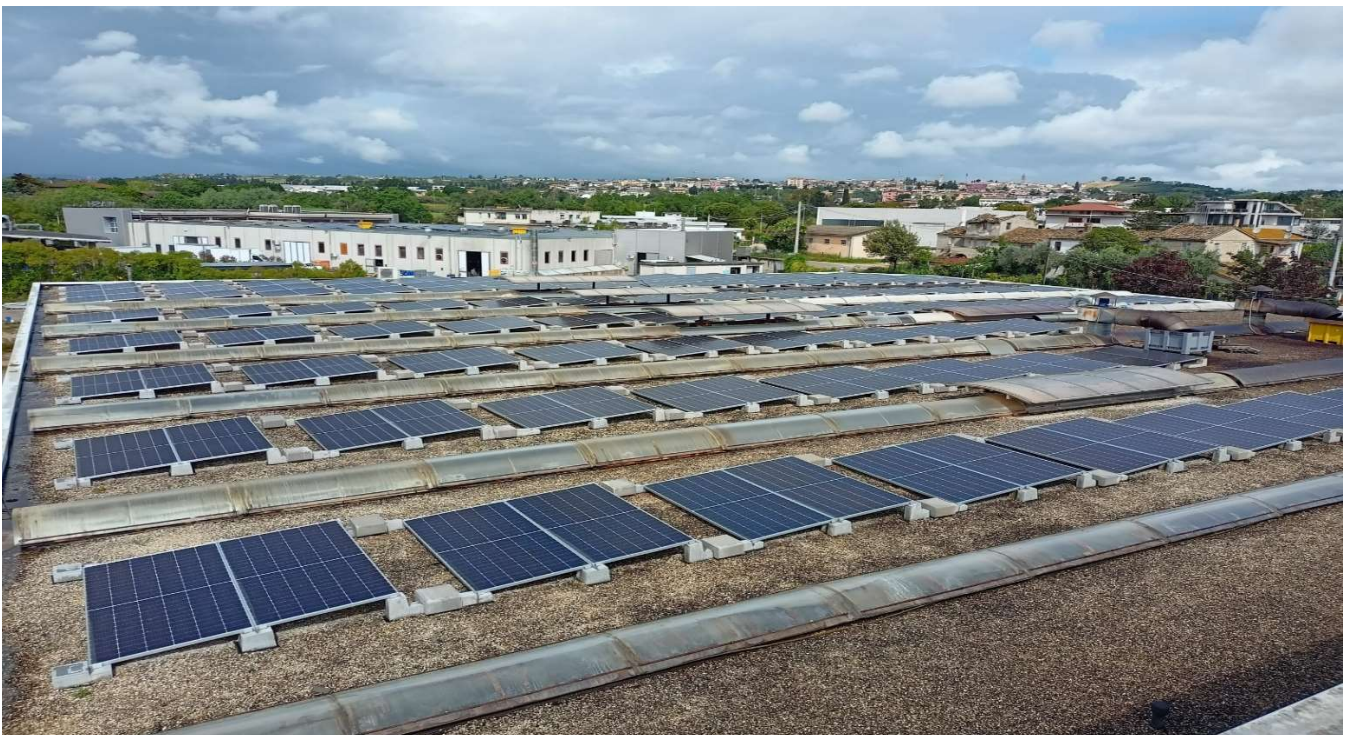
Nereto impianto su opificio industriale KwP 220
