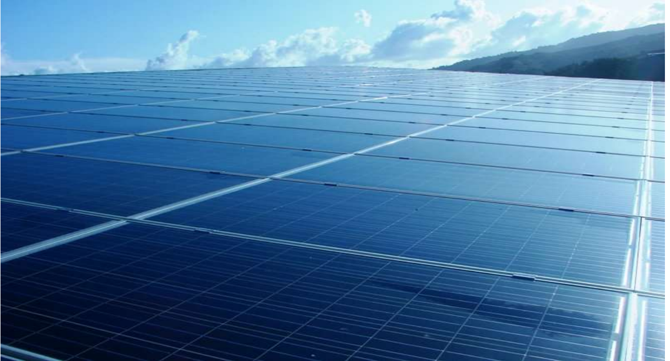
Montefiore dell'Aso impianto su opificio industriale kWp 90
