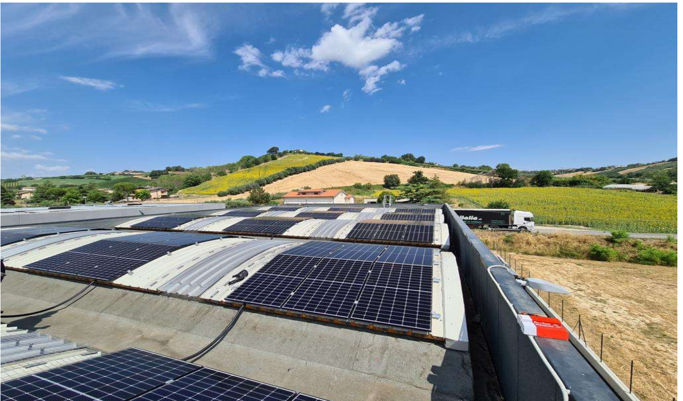
Petricoli impianto su opificio industriale kWp 72
