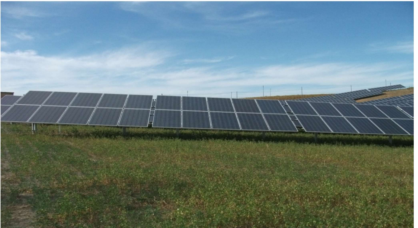
Castignano (AP) - Impianto a terra 0,500 MW
