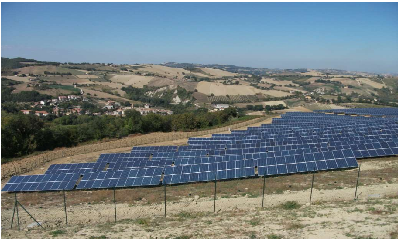
Rotella 2 (AP) - Impianto a terra da 0,998 MW
