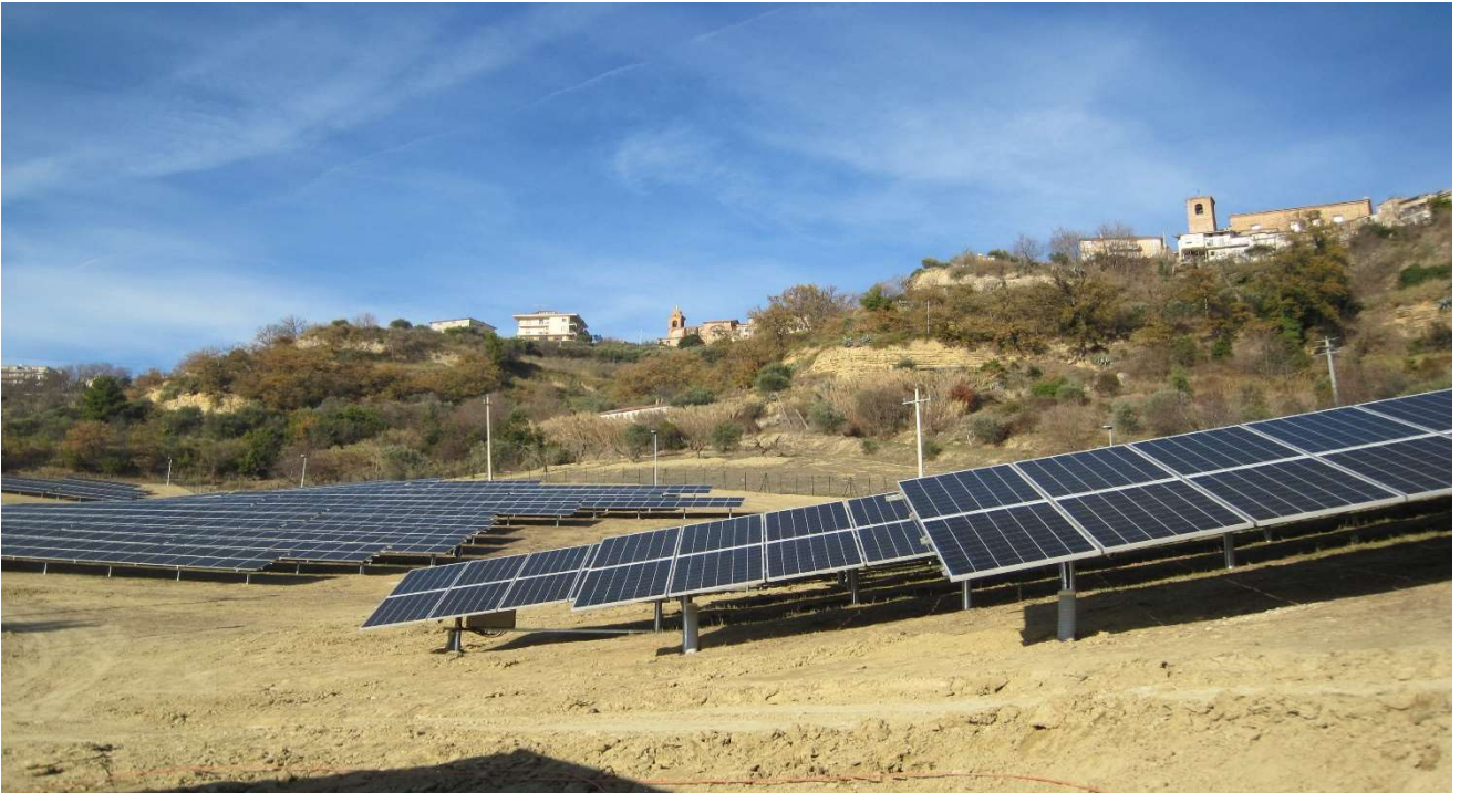
Massignano (AP) - Impianto a terra 0,780 MW
