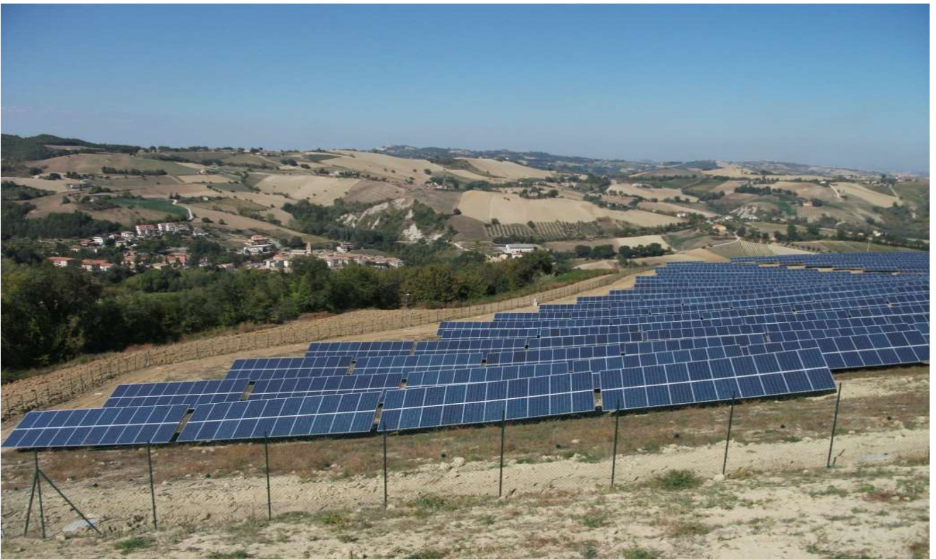
Rotella 2 (AP) - Impianto a terra da 0,998 MW
