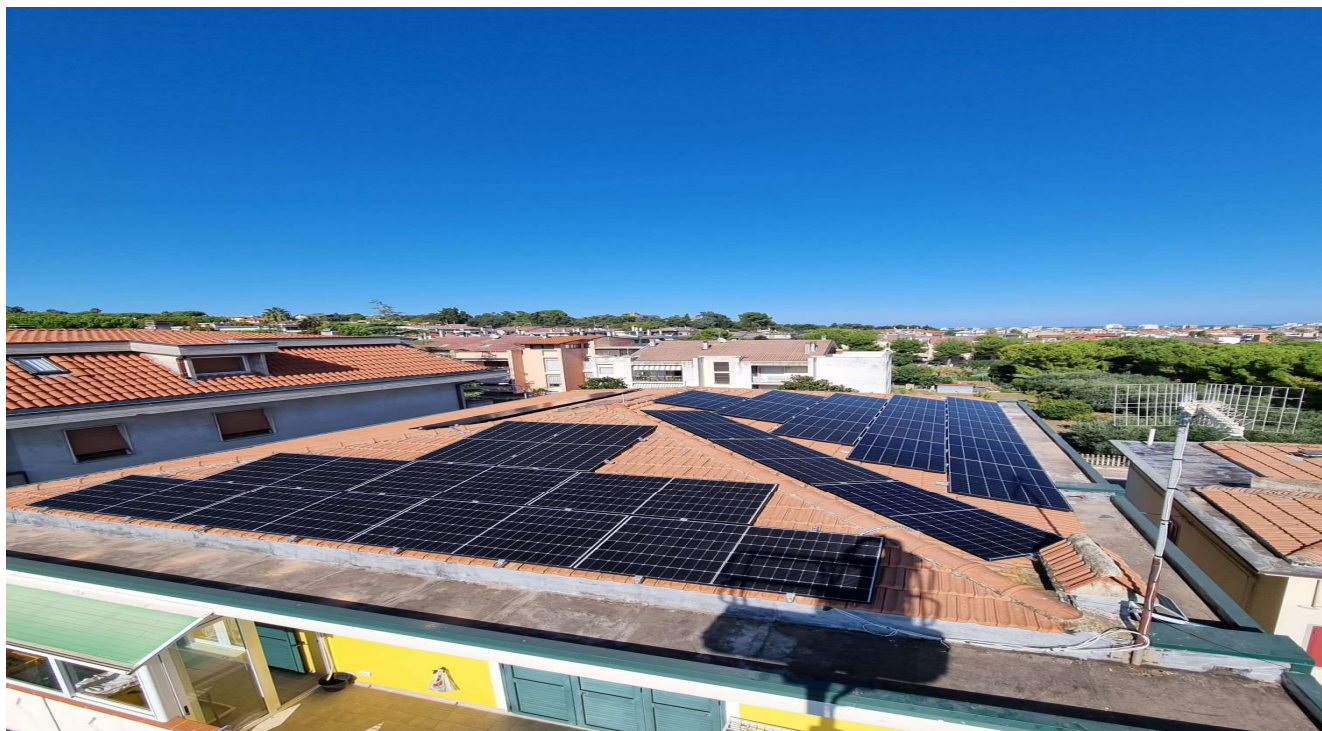
Porto d'Ascoli impianto su edificio residenziale 18 kWp
