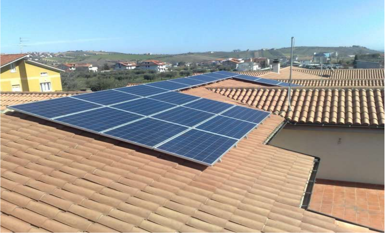
Sant'Egadio (TE) Impianto su edificio residenziale kWp 6,0
