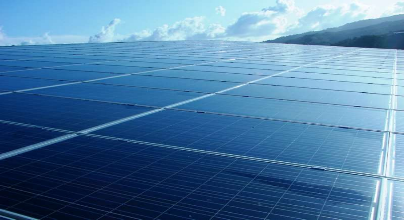
Montefiore dell'Aso impianto su opificio industriale kWp 90
