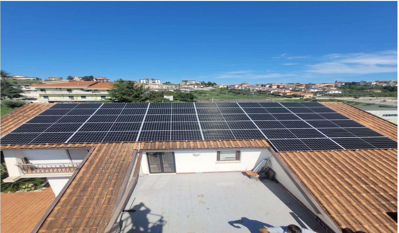
Ancarani impianto su edificio residenziale kWp 19
