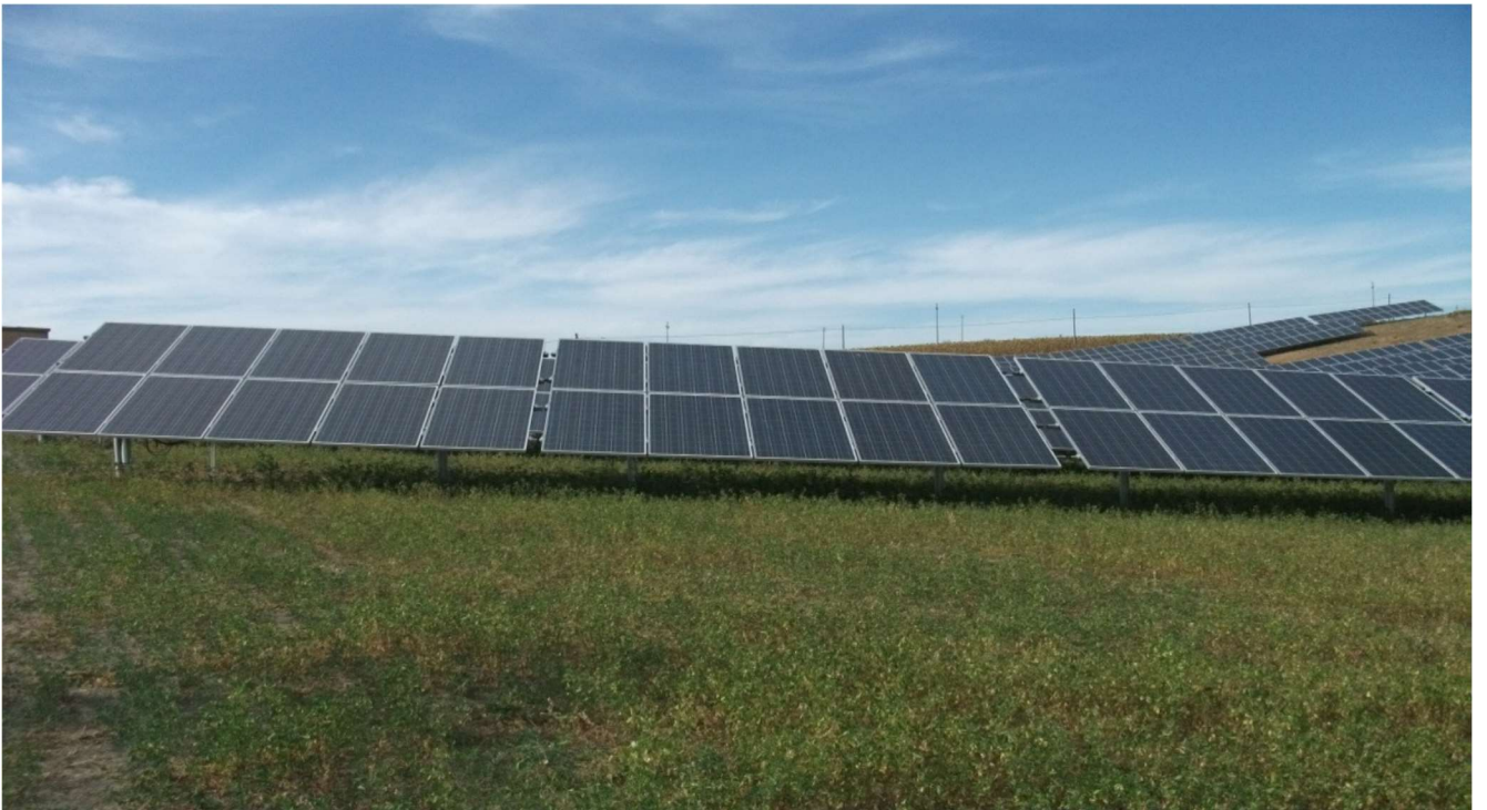
Castignano (AP) - Impianto a terra 0,500 MW
