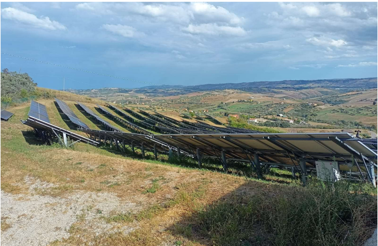
Appignano 2 (AP) – Impianto a terra da 0,440 MW
